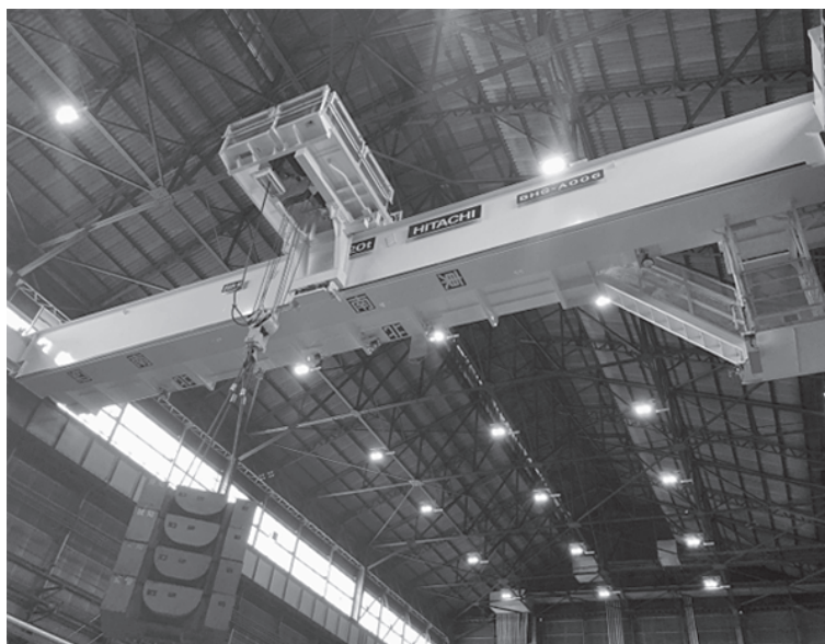
図6 コイル運搬用 20t × 19.2m クレーン（モノガーダ構造：ガーダ1本軽量タイプ）
